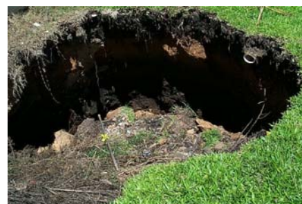
FIGURA 07 - Formação de dolina em área de risco de Colapso
