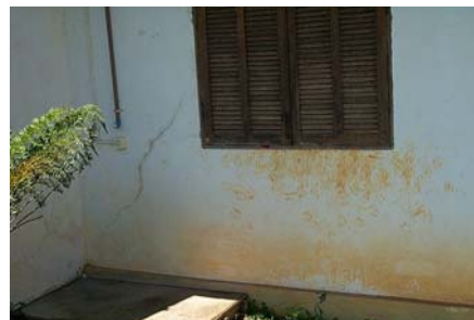
FIGURA 06 - Rachaduras em edificações, indícios de risco de subsidência.
